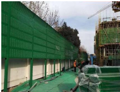
图 4-1 施工场界安装声屏障
